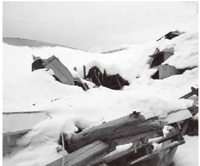
被害のあった倉庫
